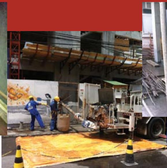
Figura 8 - Gestão da água de manutenção e limpeza dos equipamentos durante concretagem Fonte: Acervo Sinduscon-Ba
